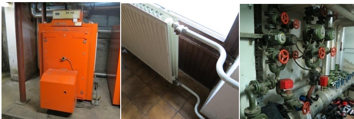
Slika 19: Toplovodni razdelilni sistem in ogrevanje prostorov
