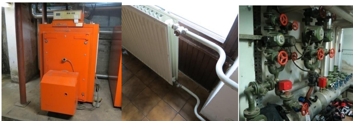
Slika 19: Toplovodni razdelilni sistem in ogrevanje prostorov
